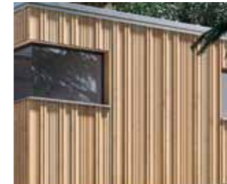
Zinkkante unterhalb der Fenster
